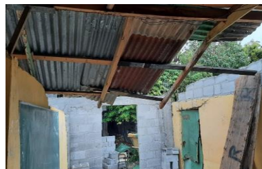
Dakdeel dat vervangen wordt
